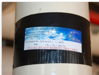
Tubería recubierta de amianto. Fuente: UEPG
